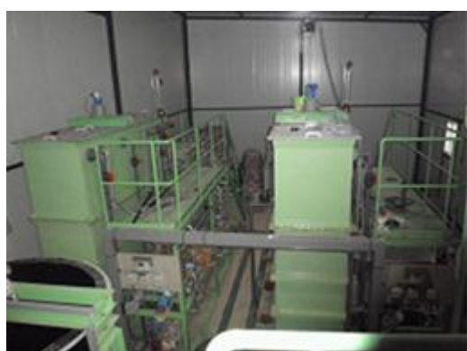
図 1.1-1 IISS 実証試験設備
