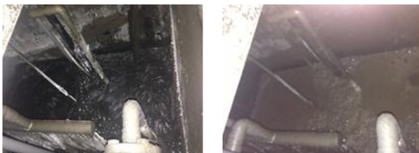
(夏季) 左: 運転停止 2 週間後の好気槽汚泥 右: 運転再開 1 日後の好気槽汚泥
