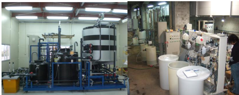
左：沖縄パイロットプラント(UF膜装置)、右：大津パイロットプラント(オゾンセラミック膜処理装置)
