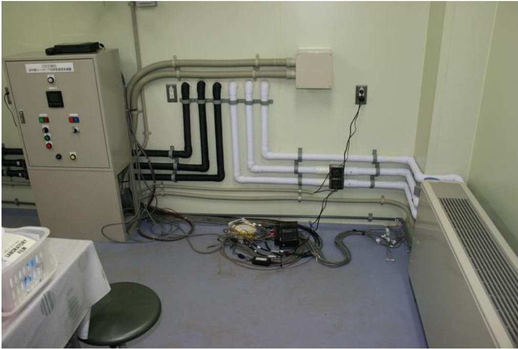
図 6-1 農工大農学 3 号館恒温室に設置した地中熱ヒートポンプシステム
