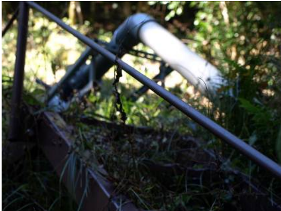
図 36 駒返しの滝小水力発電設備の導水管
