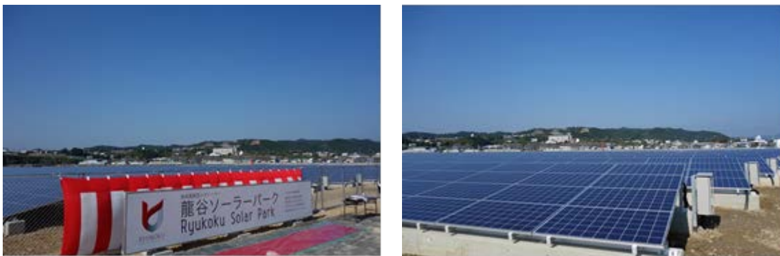
図 82 地域貢献型発電事業モデルで建設されたメガソーラー
