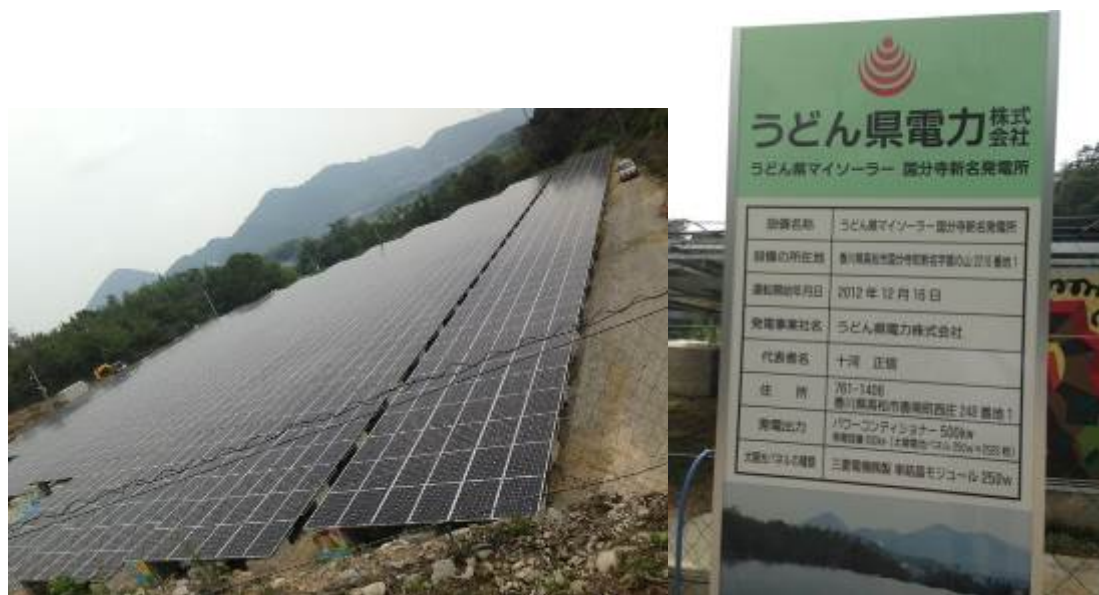
図 47 うどん県電力マイソーラー国分寺新名発電所
