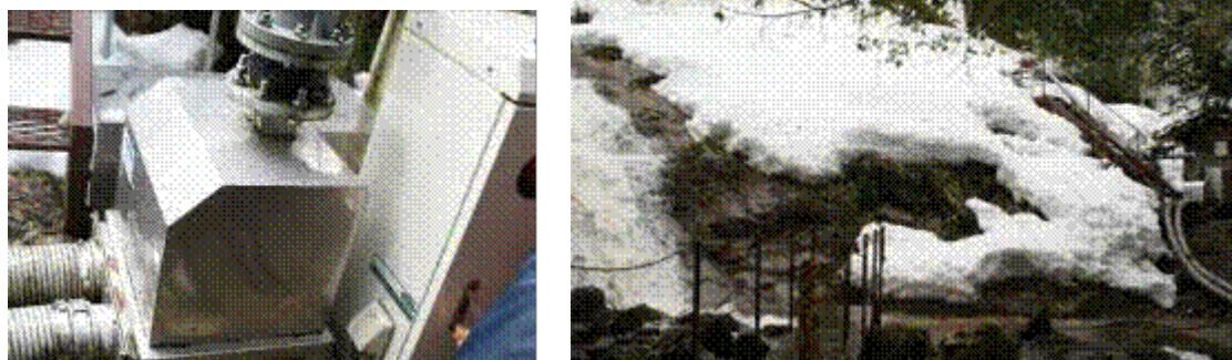
(写真) 延利の水力発電施設
