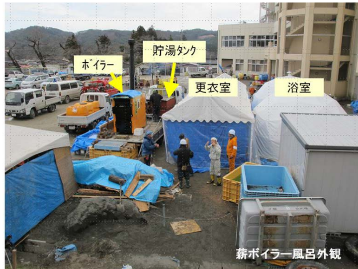
図 6 薪ボイラーと仮設風呂（岩手県大槌町）
