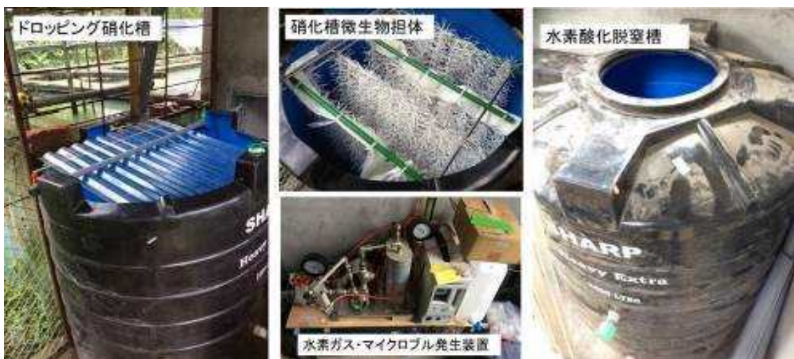
図 4.2 Jwagal 給水場に設置したドロッピング硝化-水素酸化脱窒装置
