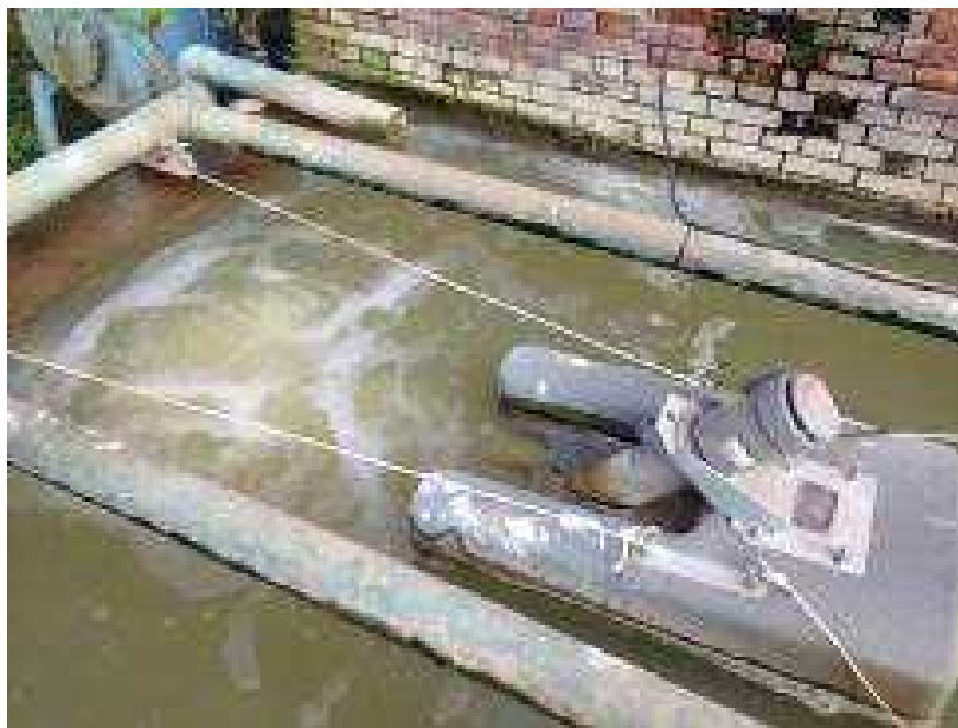
図 4.6 Jwagal 給水場に設置した小型曝気装置
