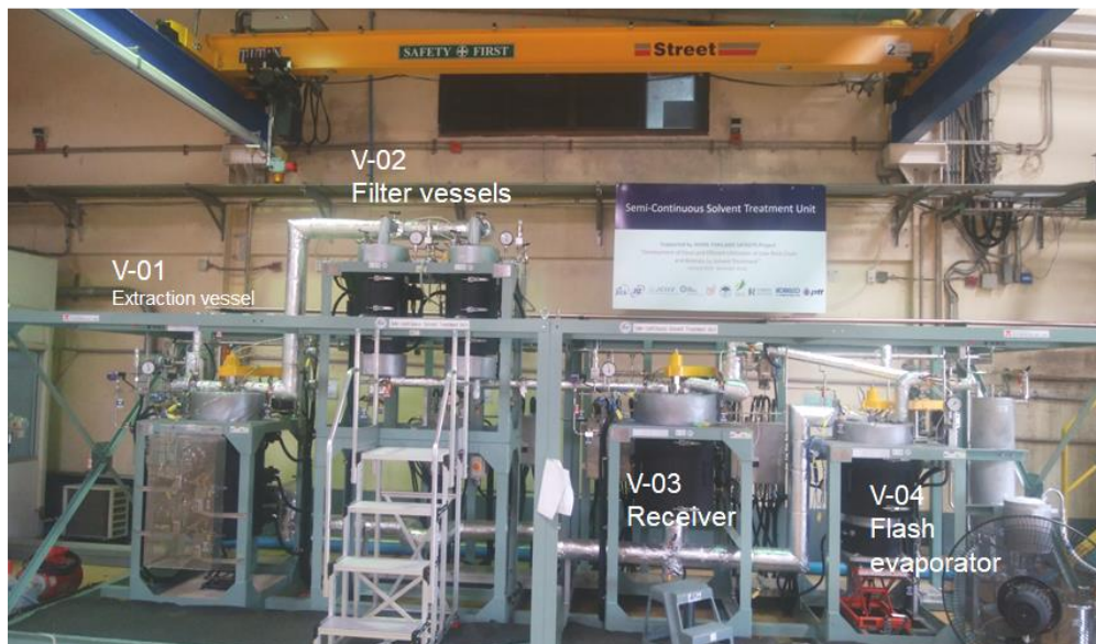
写真 1-1 半連続式溶剤改質試験装置 PTT-RTI 設置後の全景写真
