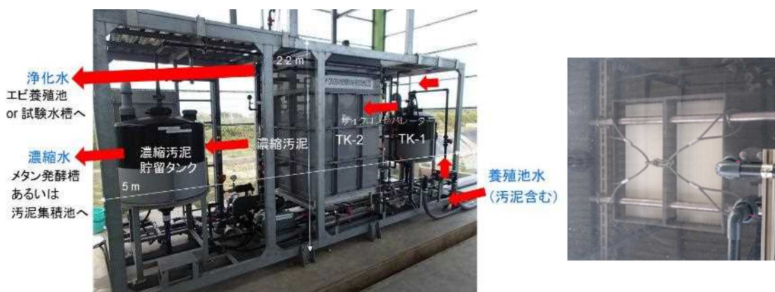
図54：ベンチ実証サイトに設置した水循環膜ろ過設備；（左）システム外観、（右）膜濾過タンク内に組み込まれている浸漬型平膜モジュール（設備上部から撮影）
