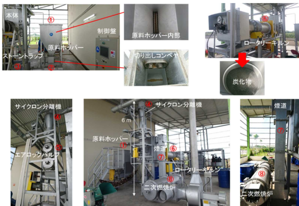
図 49：ベンチェ実証サイトに設置した炭化設備（明和工業製）
