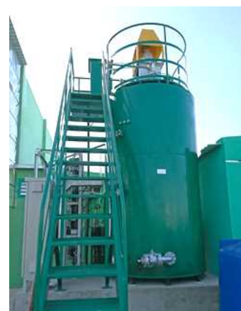
図 43：Hoang Vu エビ養殖場内に据付けた 7 \text{ m}^3 メタン発酵槽
