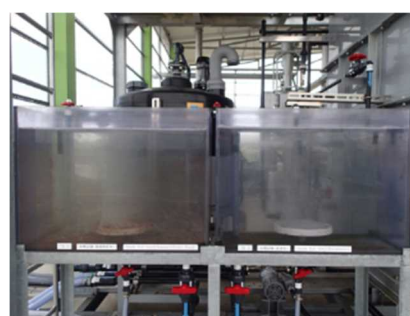
図55：膜濾過設備に設置した（左）原水水槽と（右）透過水水槽
