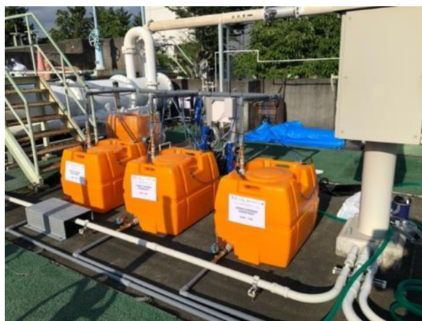
図 A-2 峡東浄化センターに設置したベンチスケール空気・水素ガス交互供給式浄化槽
