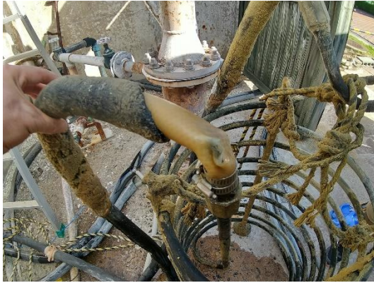
図6 温水配管の破裂
