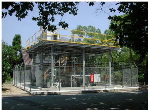
図 3.1.11 相分離系変換システムプラント (三重大学)
