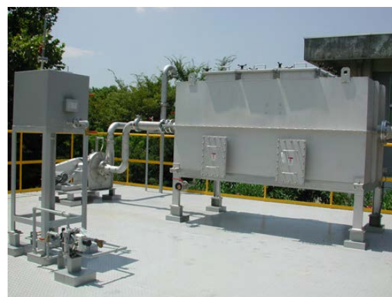
図 3.1.16 相分離系変換システムプラント (排気ミスト浄化工程)
