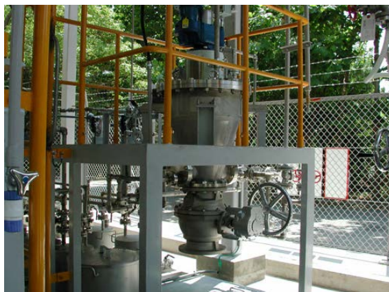
図 3.1.12 相分離系変換システムプラント (樹脂分抽出・溶媒和工程)
