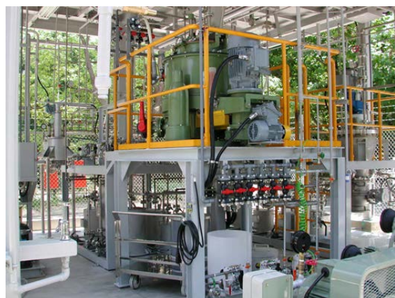
図 3.1.13 相分離系変換システムプラント (分離工程)
